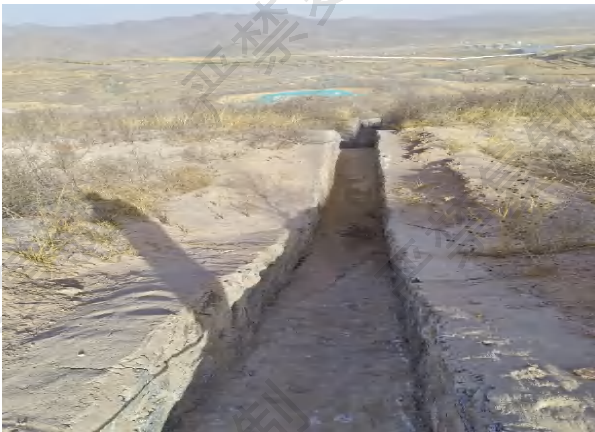
图 2.4-5 坝面竖向排水沟
